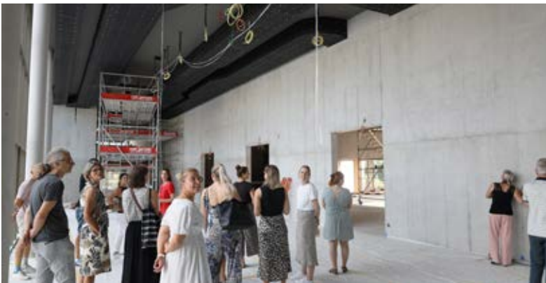
Bald wird der Neubau bezogen: Lehrpersonen besichtigen den Rohbau der neuen Kanti. (Bild Ursi Schmid)
